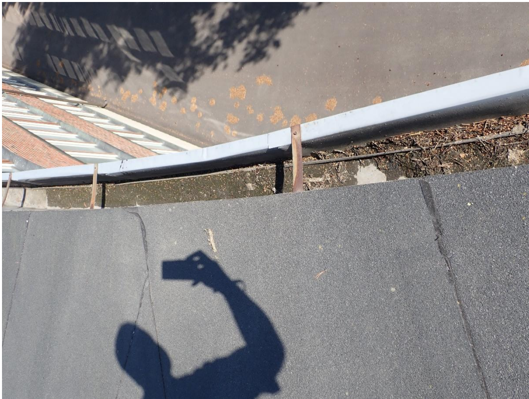
Kuva 25 Räystäskourut ovat putsaamatta.
