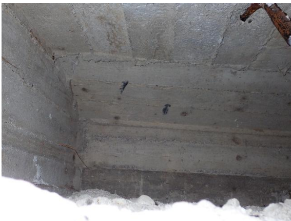
Kuva 13 Yläpohjan ja 2.kerroksen välisiä ylälaattapalkistoja ei ole tutkittu kattavasti.
