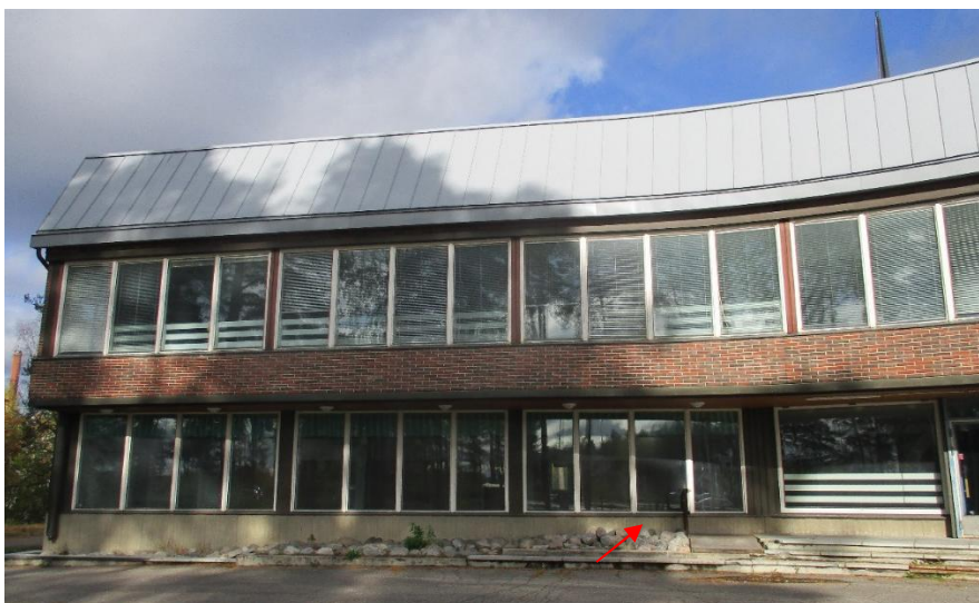
Kuva 4. Maanpinta on lattiapinnan tasossa sisäänkäynnin lähellä.
