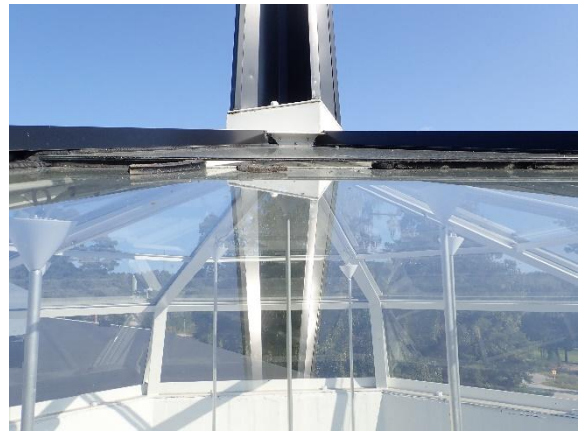
Kuva 23 Kattoikkunan ylempien lasien välinen kittausta on "hapertunut" ja paikoin ikkunoiden välissä on reikiä.
