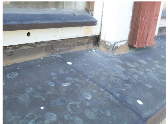
Kuva 21 Ikkunoiden vesipellitysten tiiveydet ovat huonot
