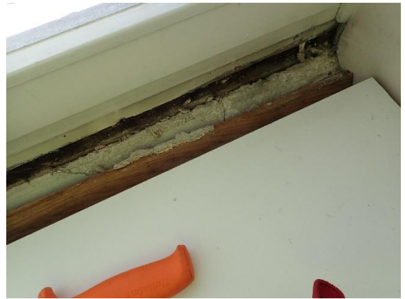
Kuva 19 Ikkunoiden tilkkeenä on käytetty rivettä, jossa on todettu mokribivaurioita.
